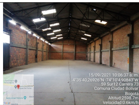
Fotografía 4. Área de bodegas y estado del suelo
